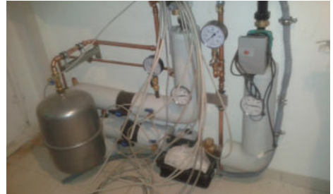
Teile der Heizungstechnik. Foto: Puschke
